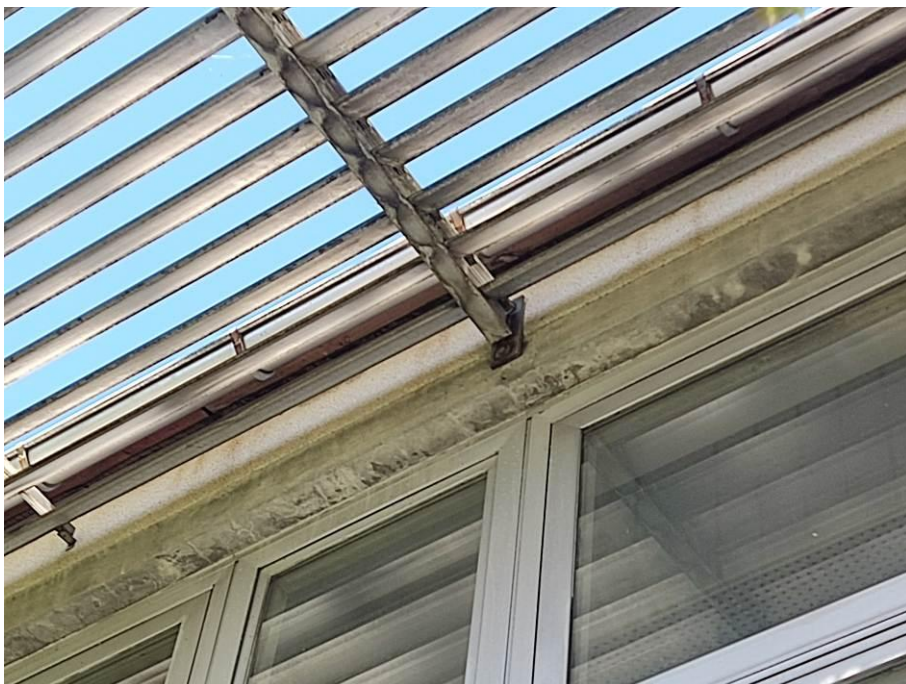
Abbildung 9: Baulicher Sonnenschutz aus Aluminium-Lamellen oberhalb der Fenster.
