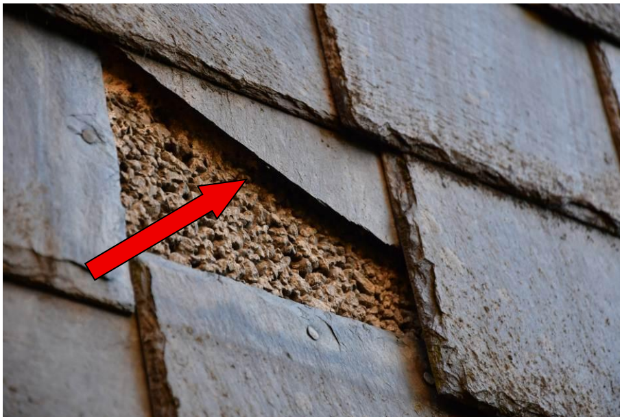
Abbildung 7: Quartierpotenzial für spaltenbewohnende Fledermäuse hinter der schadhaften Schieferverkleidung an der westlichen Seite des Gebäudes.
